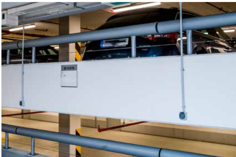
Odbočovací jednotka přípojnicového vedení Canalis napájející domovní zásuvku 2 kW - kdykoli možná rychlá záměna za nabíjecí stanici a odpovídající jištění
